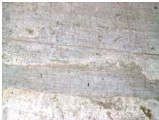
Figura 6: Remendos na superfície de concreto aparente, prejudicando a textura do material
