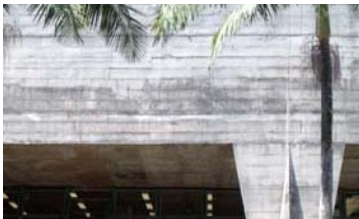
Figura 4: A degradação do concreto nas empenas externas do edifício
